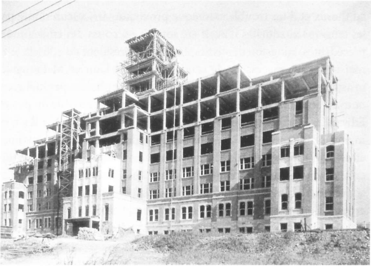
St. Mary en construction, au printemps 1934. Reproduit avec l'aimable autorisation du Dr Richard Moralejo.
